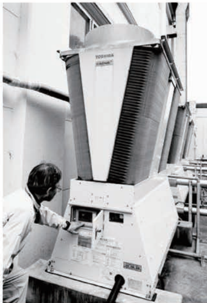
福岡工場の循環加温ヒートポンプ「CAONS」700を操作する内田リーダー
